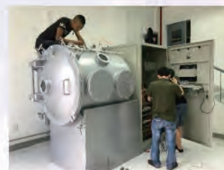
试验箱安装调试
